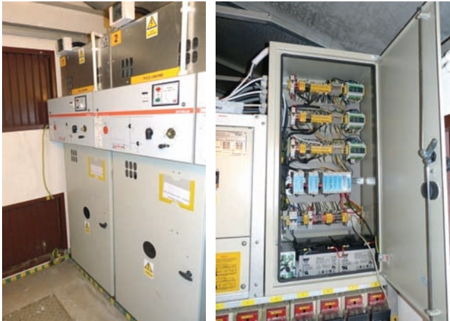
Rys. 3. Modernizacja pól rozdzielczych SN poprzez wprowadzenie mechaniki i telemetrii [27, 28]
